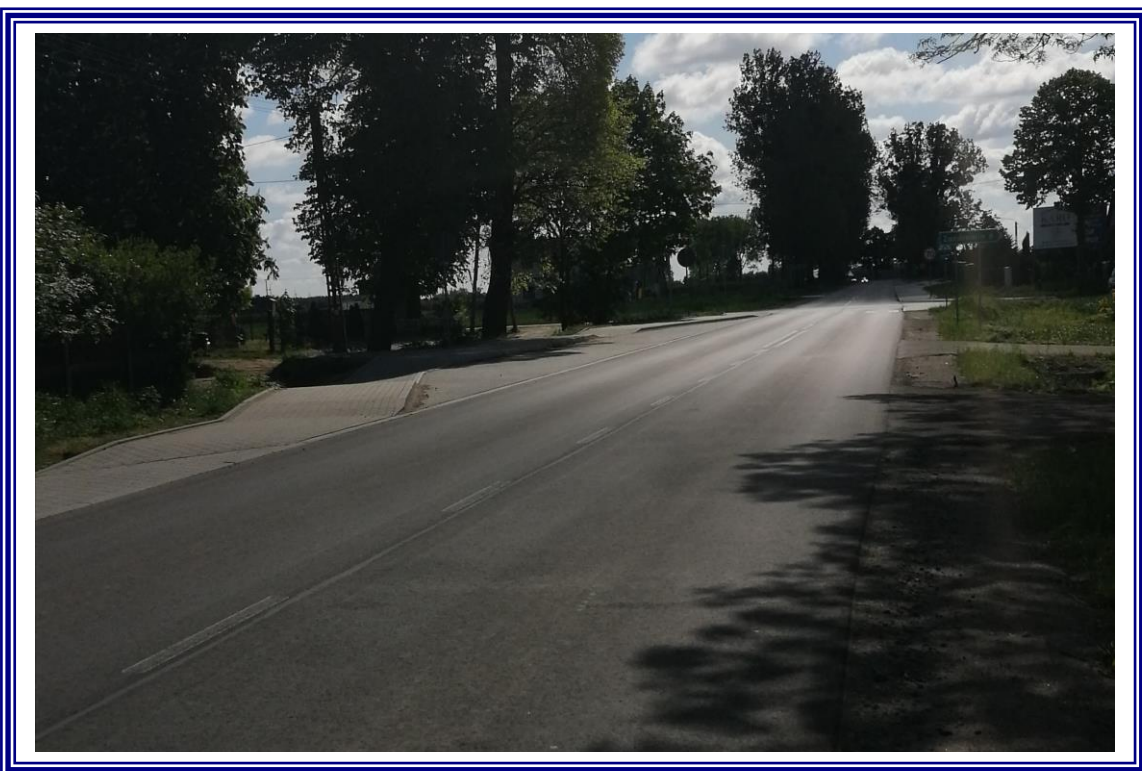
„Przebudowa drogi powiatowej Nr 2605C Stara Wieś – Nieszawa – na odcinku od km 5+888 do 7+544 – etap II”.
